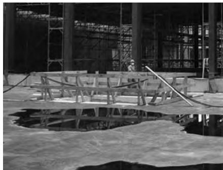
Bild 6: Kanten, Gruben und Böschungen
