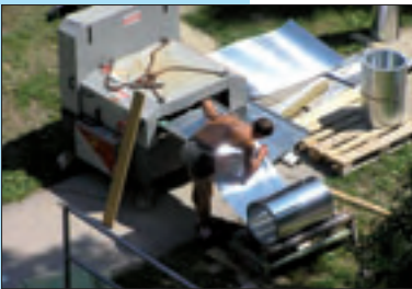
Abbildung 6: Beim Arbeiten mit polierten Metallen, die u. A. für Blechdächer verwendet werden, erhöht sich die UV-Belastung durch Reflexion an der Metalloberfläche.
