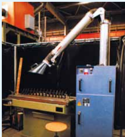
Schweißplatz mit Absaugung, bei der die abgesaugte Luft gereinigt zurückgeführt wird
