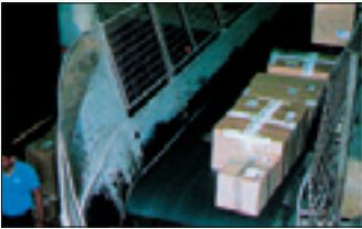
Schutzgitter und Leitbleche als Absturzsicherung
