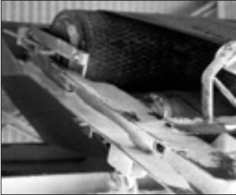
Nicht gesicherte Umlenkrolle
