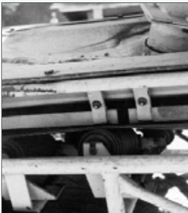
Nicht gesicherte Stützrolle unter Leitblech. Hier muss auch an der Tragrolle ein Schutz angebracht werden. Die Leitbleche verhindern nämlich das Abheben des Bandes von der Rolle; damit wird die Auflaufstelle zur Einzugsstelle.
