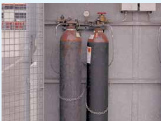
Bei Flaschenbatterien von Flüssiggas sind die Bestimmungen der Flüssiggasverordnung zu berücksichtigen
