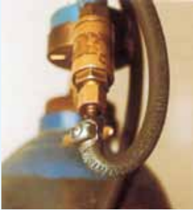
Sauerstoffschlauch, der an der Anschlussstelle der Flammenrückschlagsicherung bereits brüchig wurde
