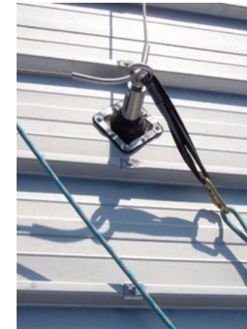
Ankerpunkt für Sicherung
