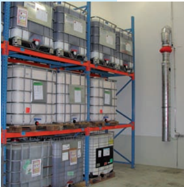
Lagerraum mit mechanischer Belüftung
