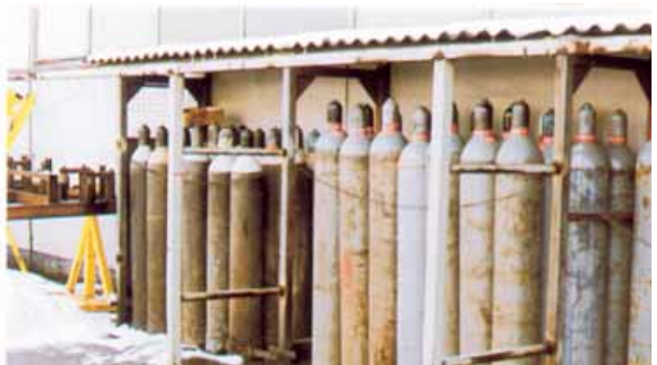
Flaschenlager: Gasflaschen mit verschiedenen Gasen sowie gefüllte und leere Flaschen müssen getrennt voneinander gelagert werden
